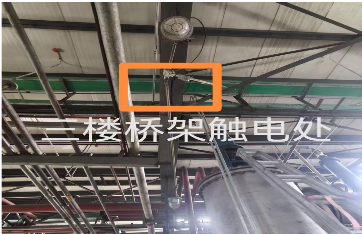
图 3 305 车间三楼电缆桥架
