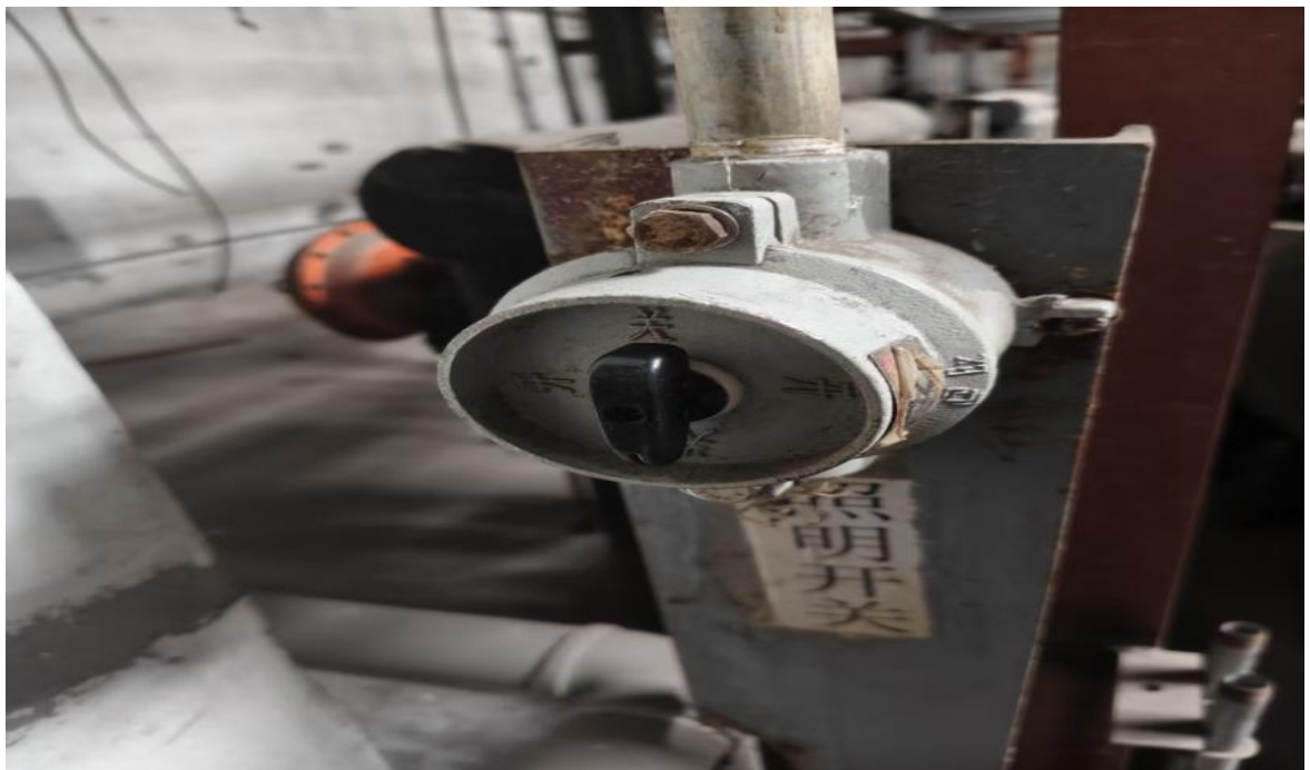
图 5 305 车间三楼照明开关
